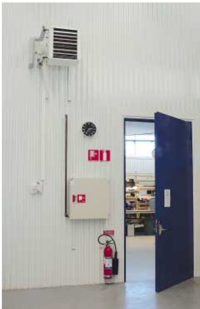
Завод на окраине Стокгольма. Тепловентиляторы FHW поддерживают комфортный микроклимат в производственных помещениях. Легкий доступ к агрегатам для проведения чистки.
