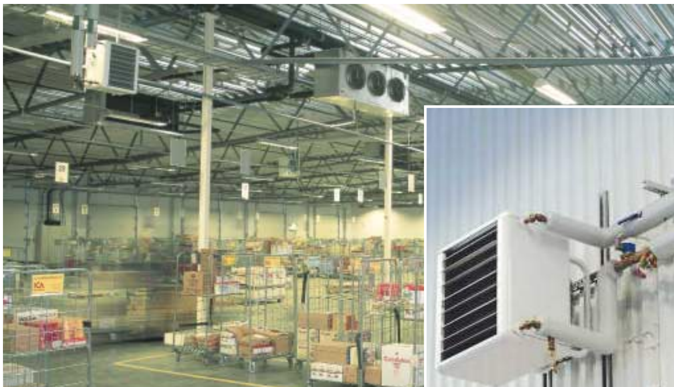
Большой теплоизолированный склад пищевых продуктов с оживленным ввозом и вывозом товаров. Скоропортящиеся продукты требуют стабильного температурного режима. Восемь тепловентиляторов FHW12 обеспечивают быструю подачу тепла для поддержания заданной температуры.
